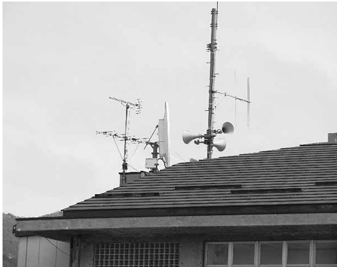
役場屋上に設置されている防災行政無線アンテナ。
