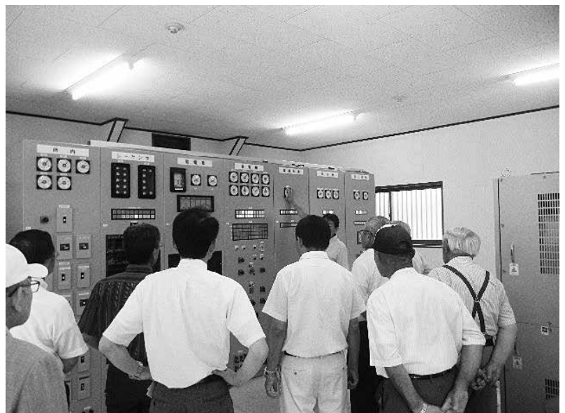
奈良県下北山村の小又川発電所。
