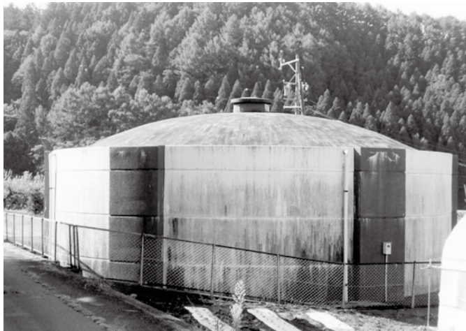
需要期の水道を補うための貯水を兼ねた配水池。
