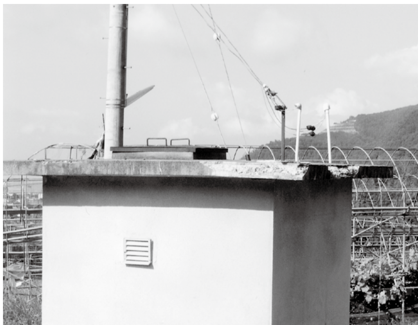
計画的に、老朽化した施設の更新を。
