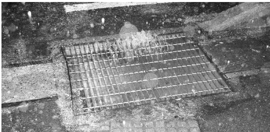
この交差点はちょっとした降雨で側溝のグレーチングから排水が噴出します。6月22日夜の状況。この程度の雨でもあふれてしまうので、土砂降りの時は大変なあふれ方になります。
