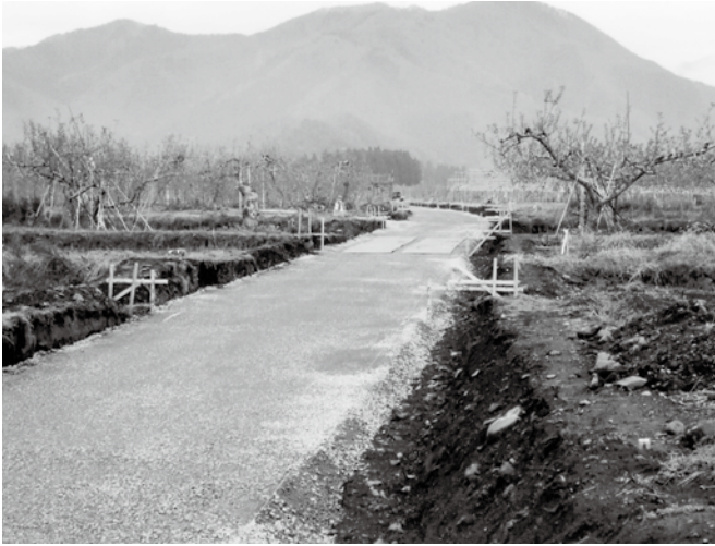
明治沖工区農道工事。現道の拡幅改良及び用水路の改修。全長461m、幅員4.5m、舗装4mの計画。
