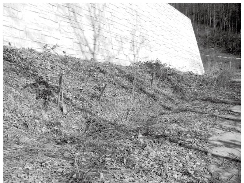
滝ノ入堰堤に植栽した樹木が枯れている。
