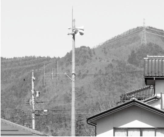
現在の防災無線が老朽化したため、家庭の放送は光ケーブルを使った有線放送になりますが、屋外の放送はデジタル化された無線で放送されます。
