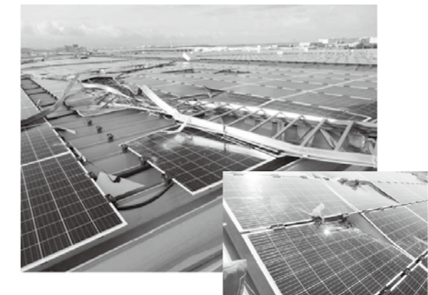
自然災害による太陽光電池パネルの損壊・飛散事故が経済産業省のHPで報告されており、昨年の台風21号や西日本豪雨による事故などが載っています。今年の台風15号でも事故がありました。(経済産業省 新エネルギー発電設備事故対応・構造強度WGの資料から)
