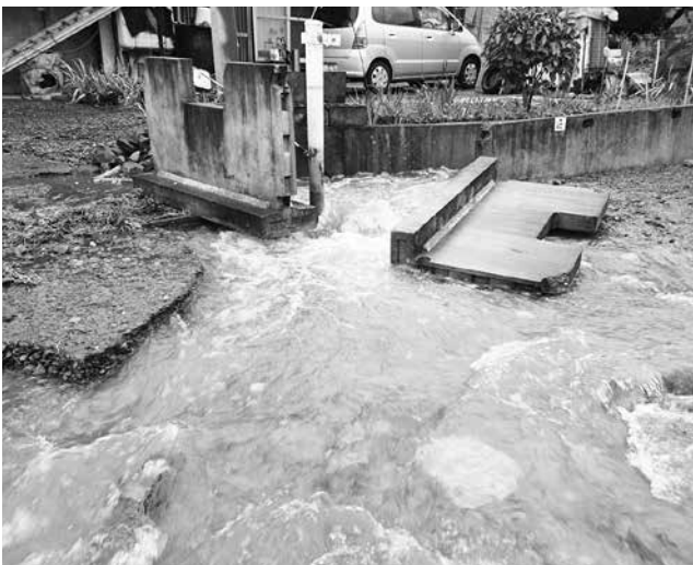
樋沢水路越水により倉庫敷地内浸水、水路一部損壊。
