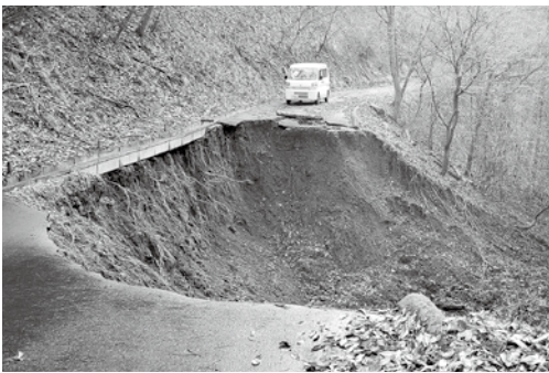
林道矢崎線の崩落で、農業用ため池に土砂流入(林道の崩落等、林道湯沢線など14か所)
