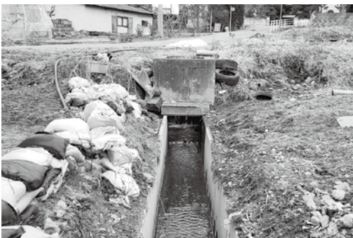
下流に幅の狭いU字溝部分がある。豪雨のたびに越水している。
