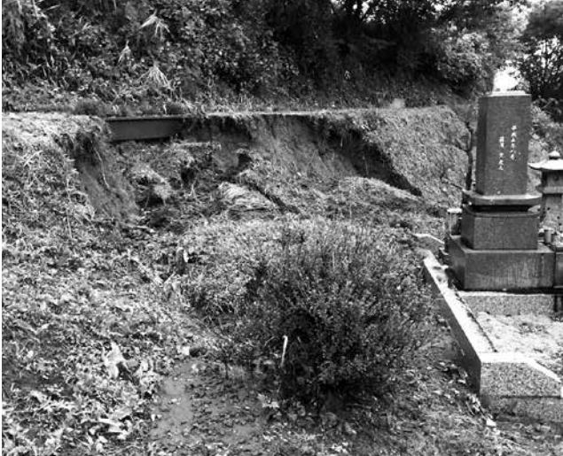
用水路が越水して法面崩落。
