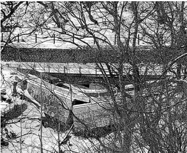
豊野南志賀公園線八滝上での路肩崩落。仮説栈橋設置工事が終了し11月19日より、大型車両も通行可能。
