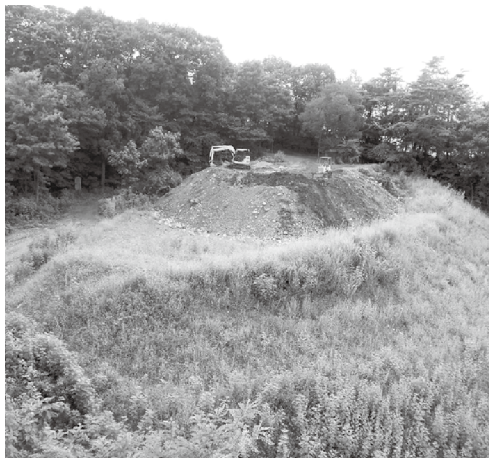
飽和状態になった土捨て場。
