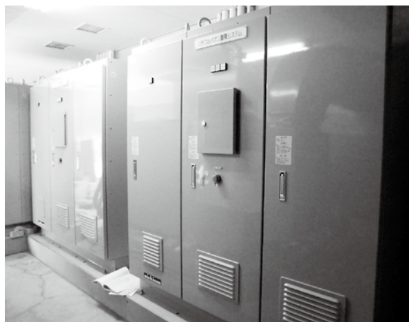
蓄電池システム。非常時、夜間等配電ができます。
