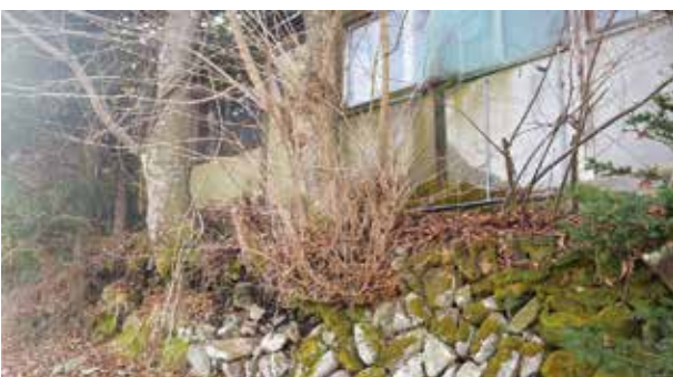
石の擁壁が崩れ倒壊の危険がある空き家。
