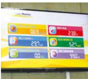
庁舎正面玄関に設置してある発電量等監視モニター。
