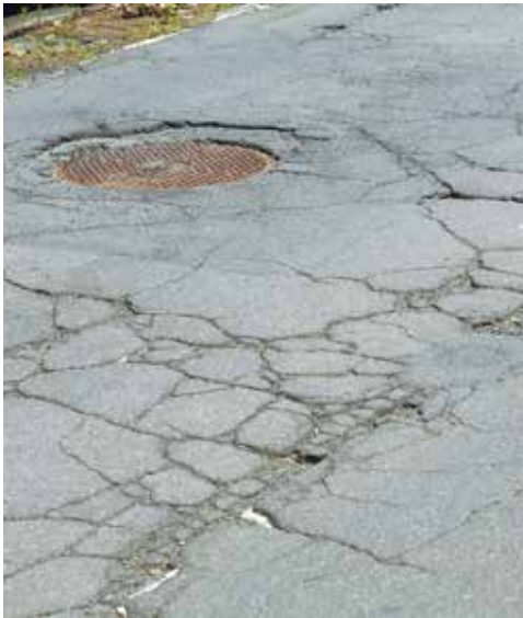
マンホールの段差とひびや穴が危険な道路。
