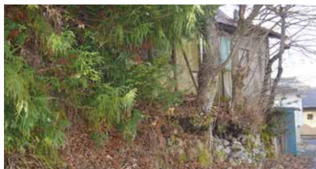
倒壊の危険がある空き家
