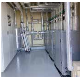
ヒートポンプの熱交換機3台
