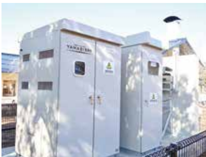
屋外に設置した蓄電池設備（145kw）
