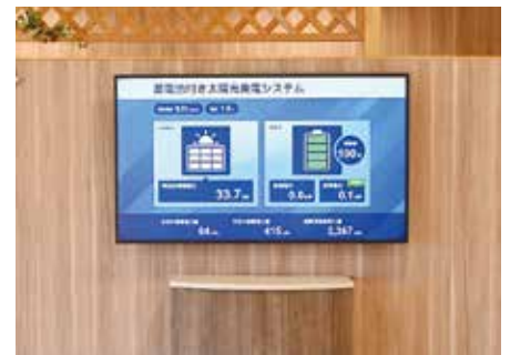
玄関に設置した発電量等確認用モニター
