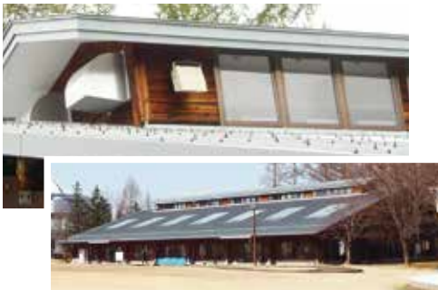
YOU 遊ランド多目的ホールの天窓と換気設備
