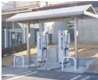
軽井沢町営EV車用充電スタンド。(役場駐車場内)
